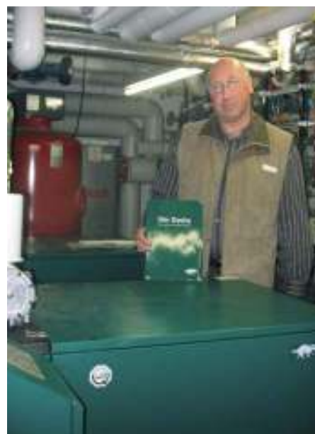
Mit dem Betrieb der zwei Blockheizkraftwerke, so die Aussage von Hartmut Paulmann als technischem Mitarbeiter der Hausverwaltung Isernhagen, arbeitet die Anlage wirtschaftlich und umweltschonend und produziert zugleich energiesparende Wärme und Strom.
